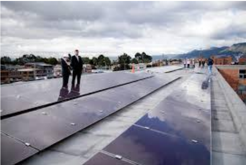
Autogeneración (1 kW – 10 kW)
