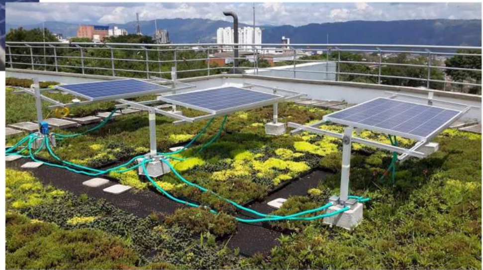
Techo Biosolar. UIS Bucaramanga 2012
