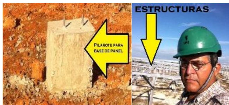
Figura 3: Datos generales de instalación de módulos fotovoltaico DSM-250 Fuente: Elaboración propia.
