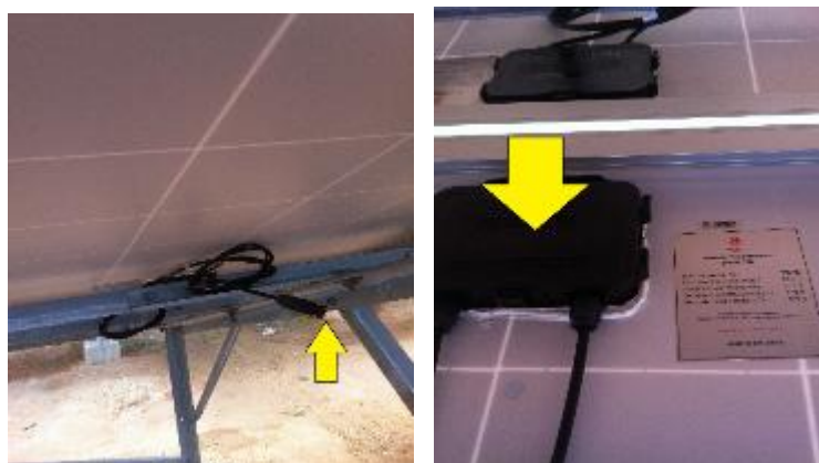
Figura 4: Interconexión eléctrica entre mesas. Fuente: Elaboración propia.
