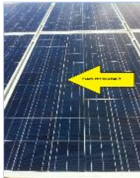
Figura 5: Módulo fotovoltaico. Fuente: Elaboración propia.
