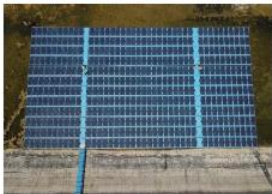
Bodega – Bombeo de autoconsumo (PPA) – Gran bodega – San Felipe (Chile)
