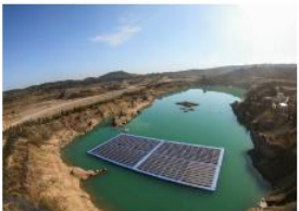
Agricultura – Bombeo solar directo – C.R Real de Montroi (España)
