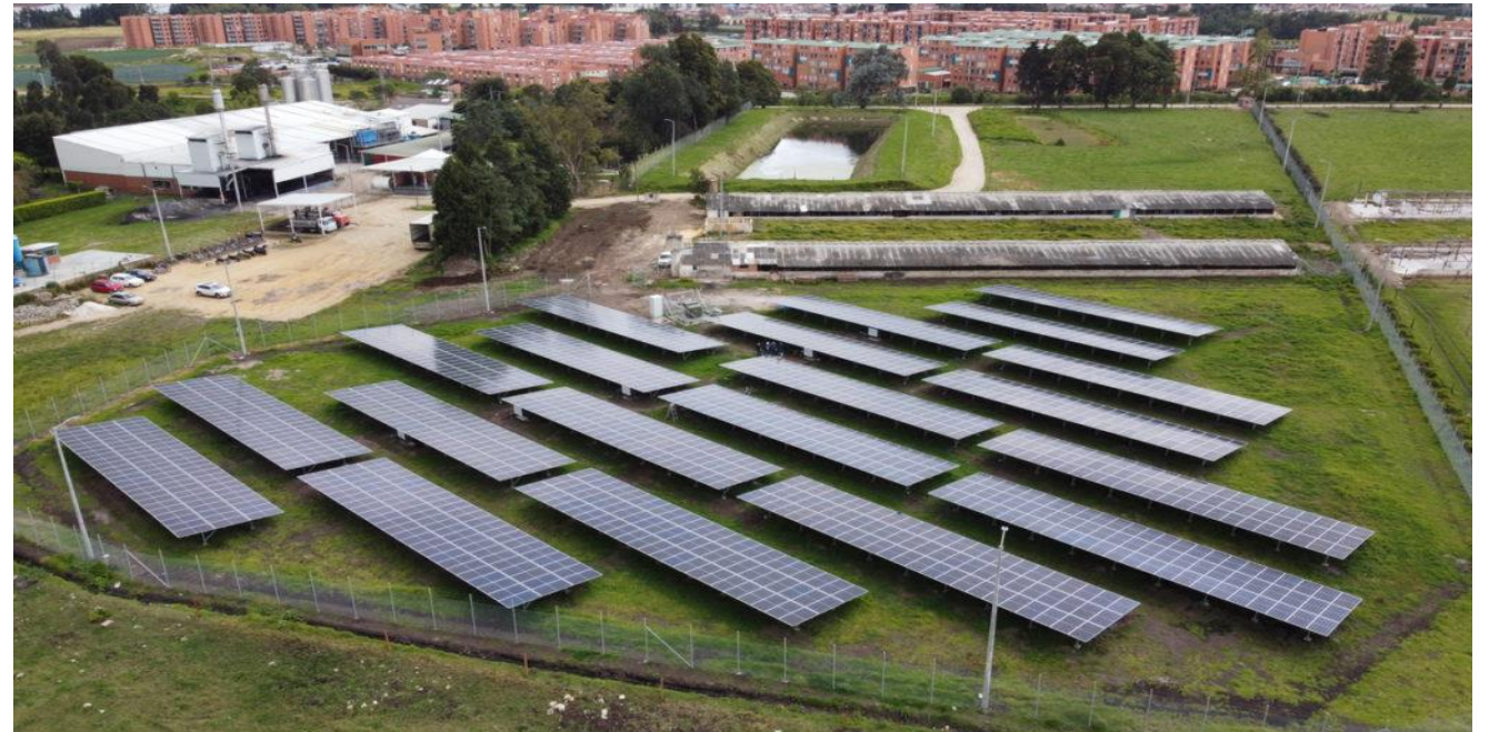
Lácteos la Esmeralda (Madrid, Cundinamarca- 669 kW) Fuente: ESSI – Copower
