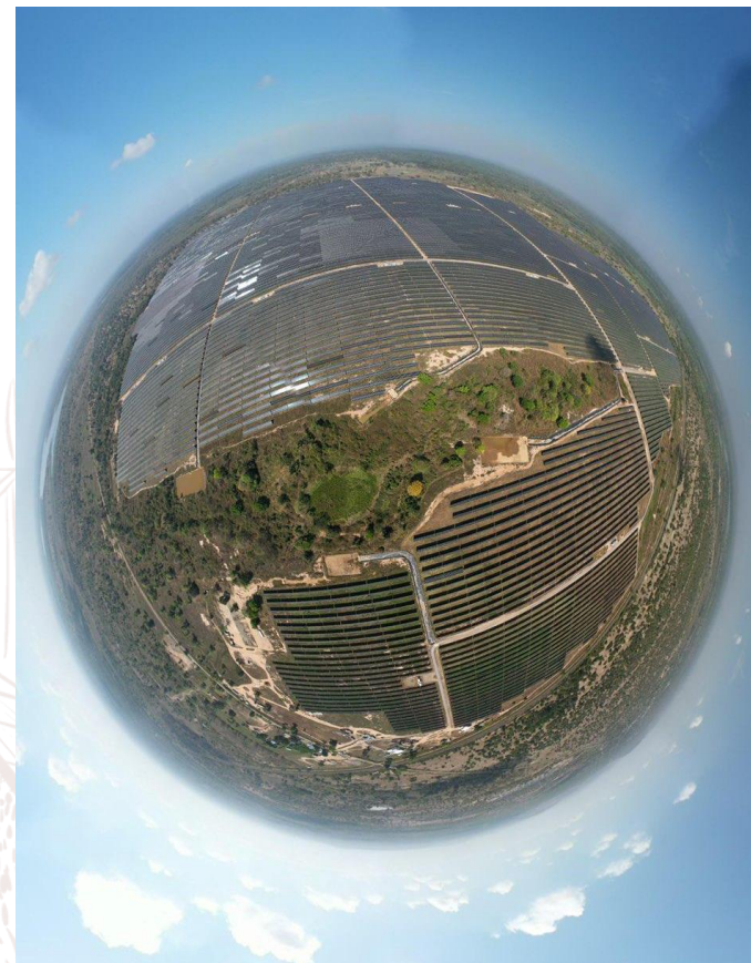
Parque solar La Loma, Cesar – 150 MW Fuente: Ministerio de Minas y Energía.
