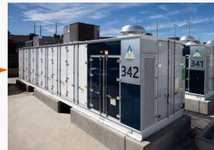
Sistema de Almacenamiento con Baterías (SAEB) 45 MW / 52 MWh
